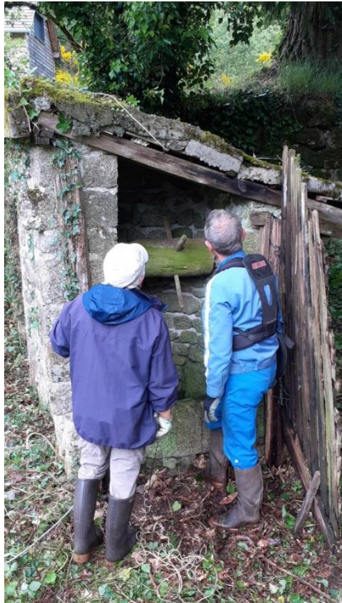
Claude et Gérard constatent l'état préoccupant de la toiture.
