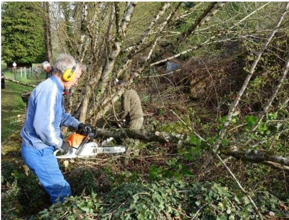
Début du chantier, Gérard et Christian armés de leurs tronçonneuses entrent en scène.
